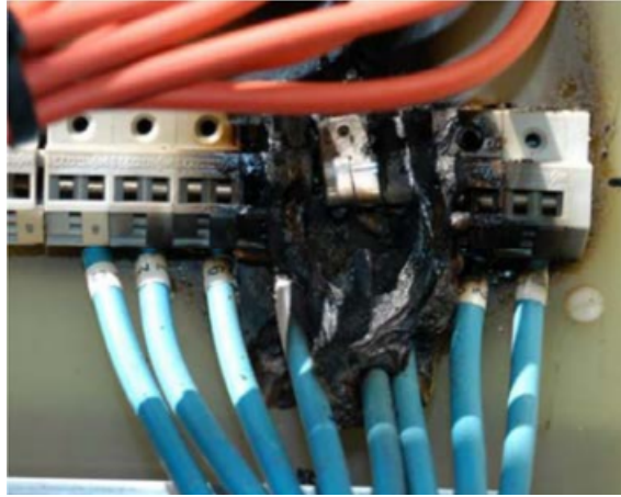
FIGURE 5 – Dégâts causés par un arc électrique Source : Thèse [1]
